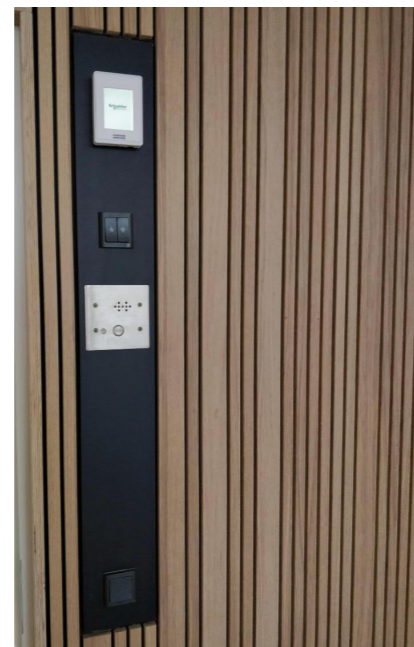
Eksempel betjeningspanel ved indgangsdør til lokalet (Eksempel fra Lykkebo Skole)
