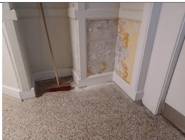
Lokalt ud for udvendigt nedløbsrør
