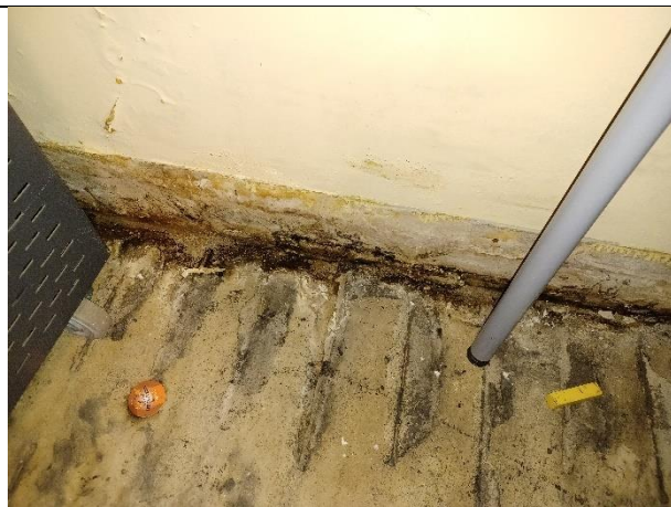
Nabolokale til lokalet med rørskade. Opfugning og skimmel ved skillevæg.
