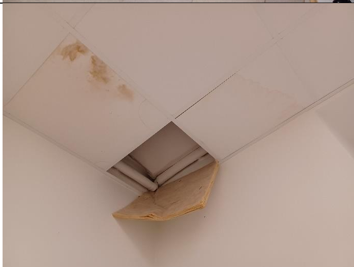
Skjolder på loft efter vandskade
