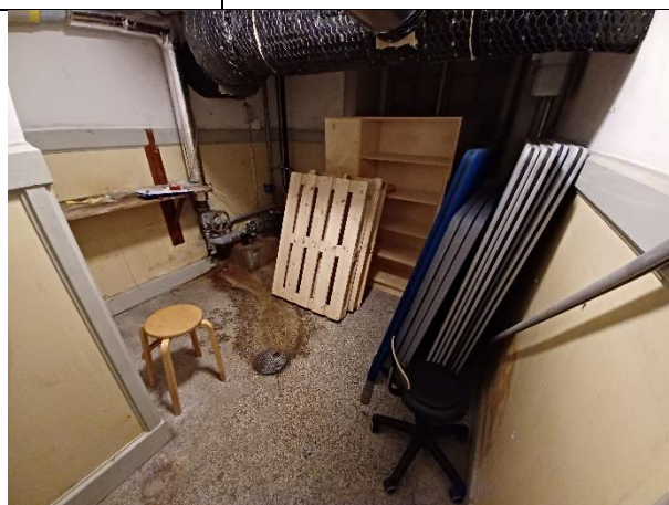
Lokale tv. for vaskerum. Rørskade.
